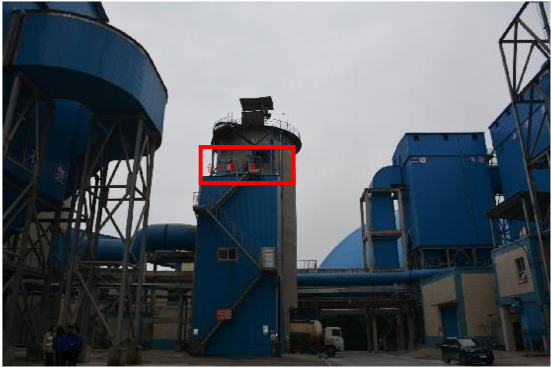
图 4.1-6 1#焚烧炉配套灰库仓顶除尘器
