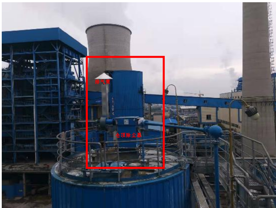
图 4.1-12 2#焚烧炉配套飞灰库仓顶除尘器
