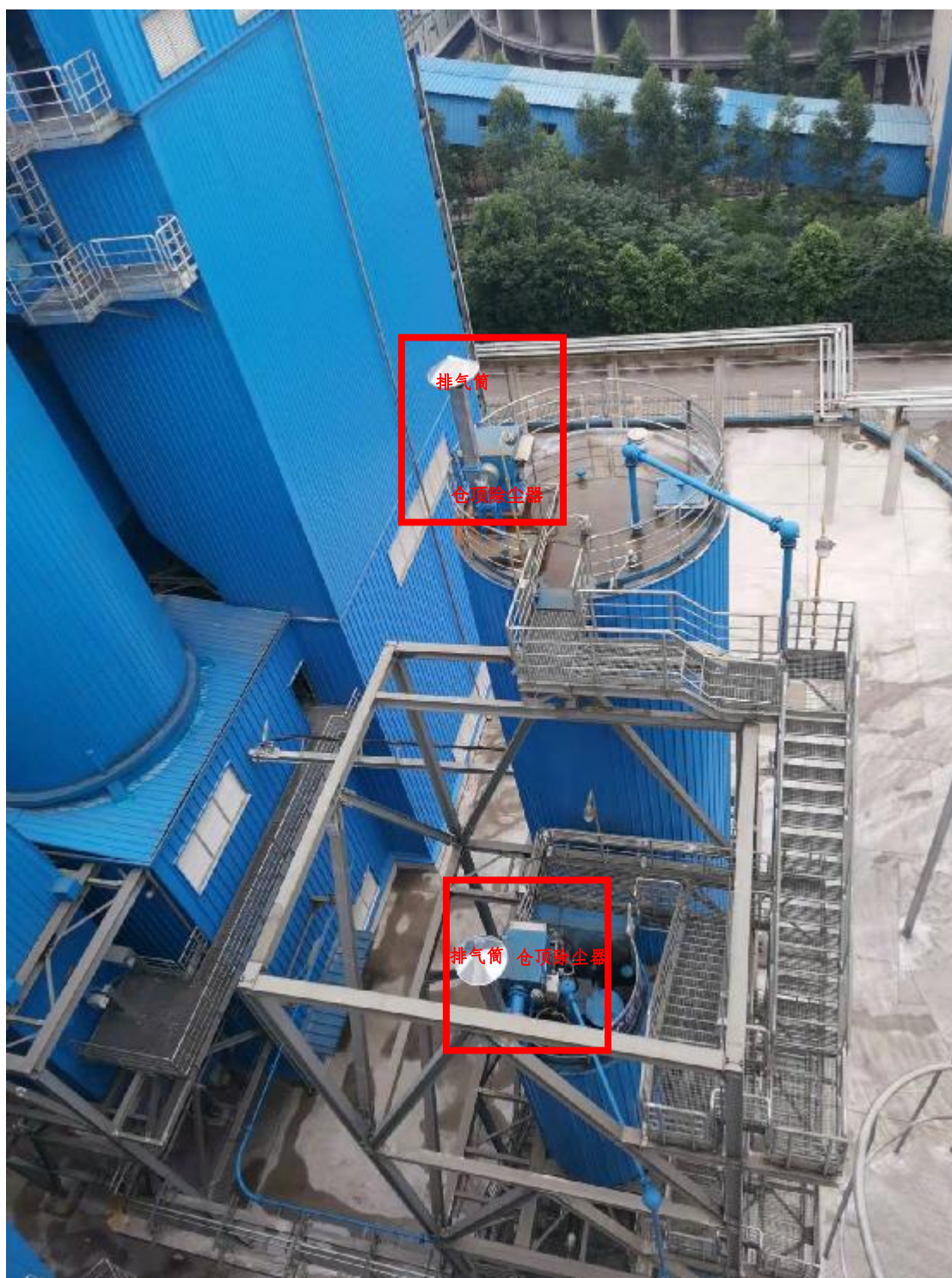
图 4.1-11 2#焚烧炉配套活性炭仓和石灰仓仓顶除尘器
