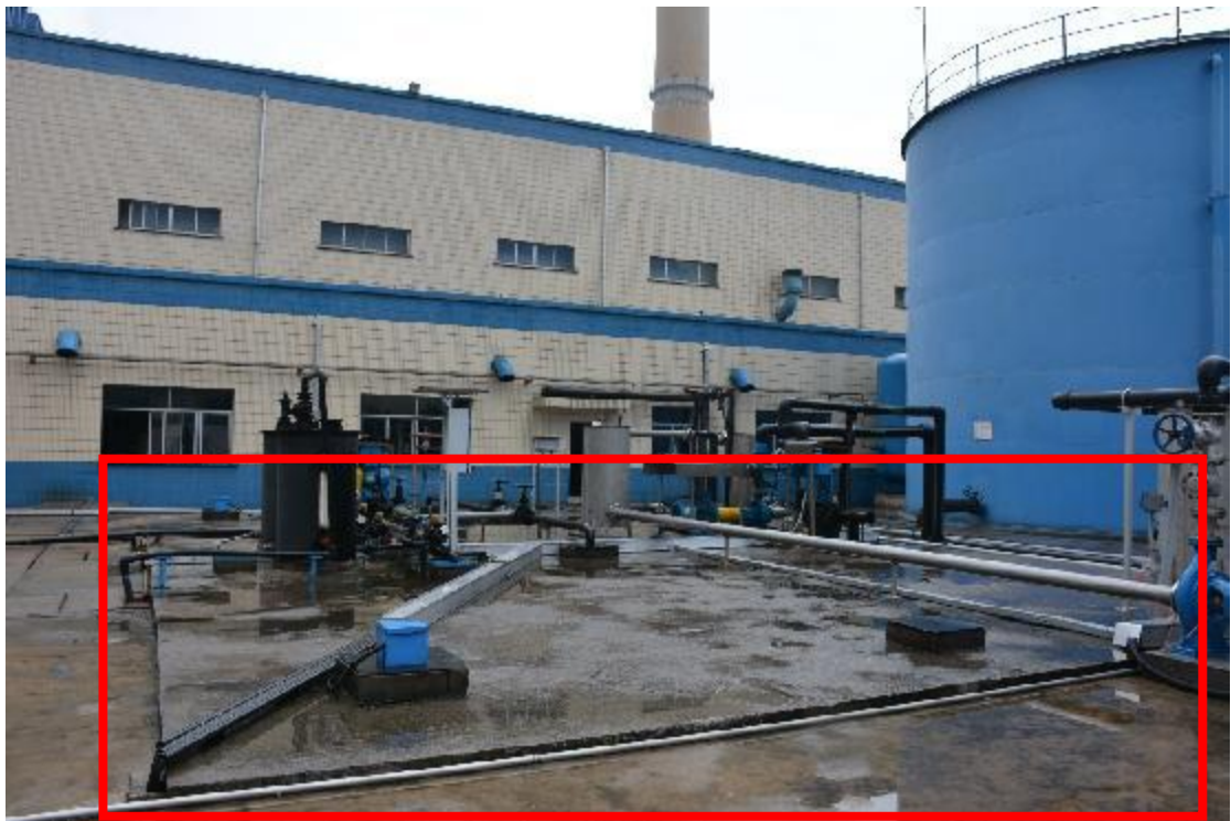
图 4.1-14 化水站酸碱废水中和池（地下式）
