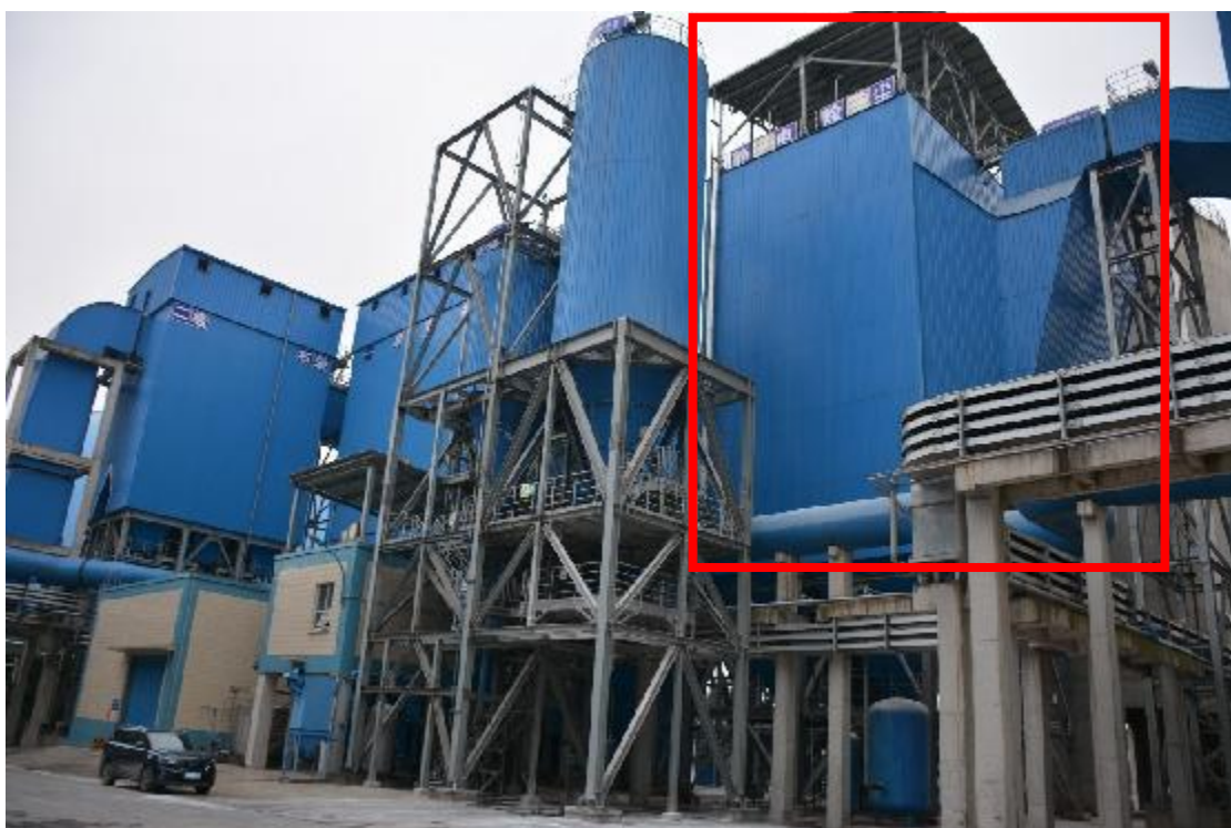
图 4.1-8 2#焚烧炉配套静电除尘器
