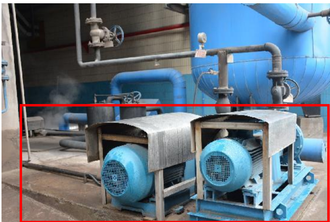
图 4.1-16 冷渣机排污水收集池（地下式）及提升泵
