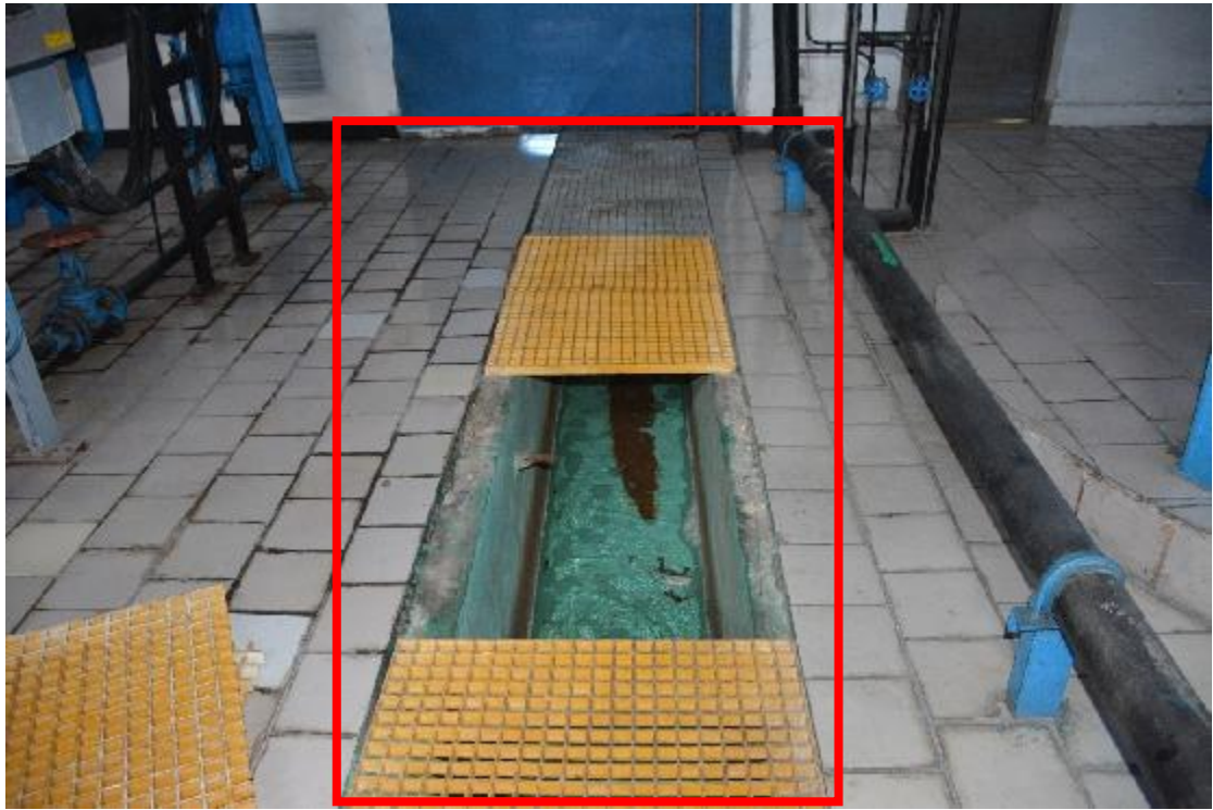
图 4.1-13 化水站酸碱废水排放沟（地下式）
