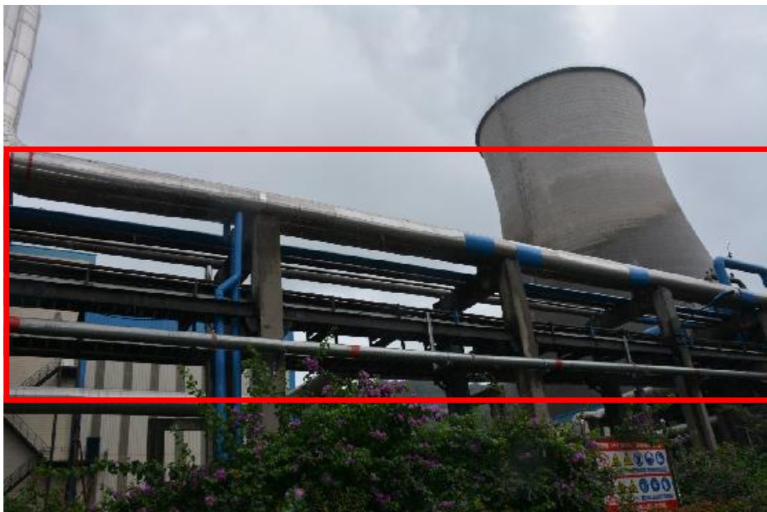
图 4.1-17 污水输送管廊
