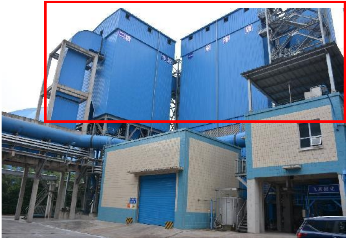
图 4.1-10 2#焚烧炉配套一、二级布袋除尘器
