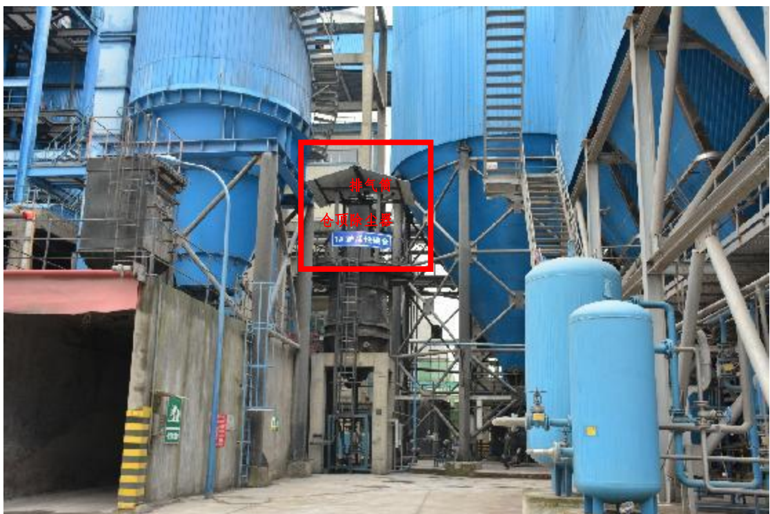
图 4.1-5 1#焚烧炉配套活性炭仓仓顶除尘器
