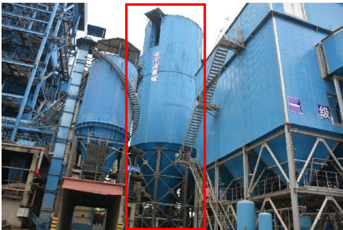
图 4.1-3 1#焚烧炉配套半干法脱硫塔
