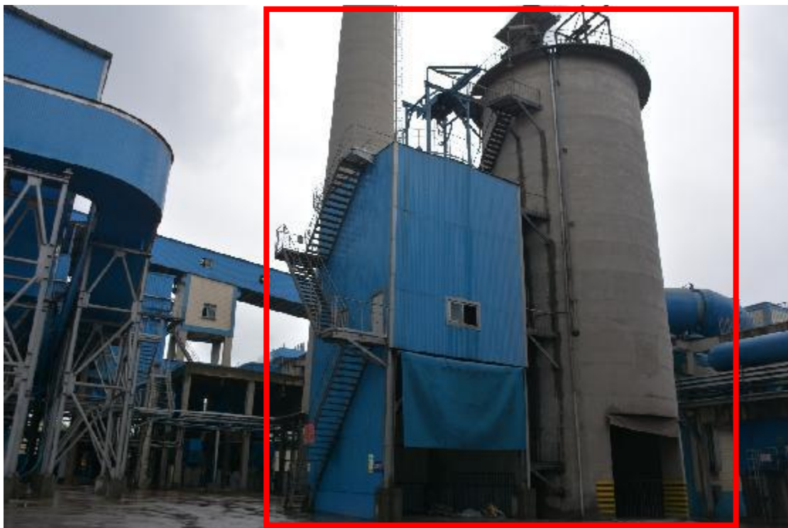
图 4.1-2 1#焚烧炉配套尾气处理系统（2）
