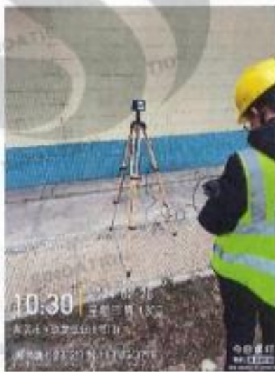
变电站西南方向外 5m
