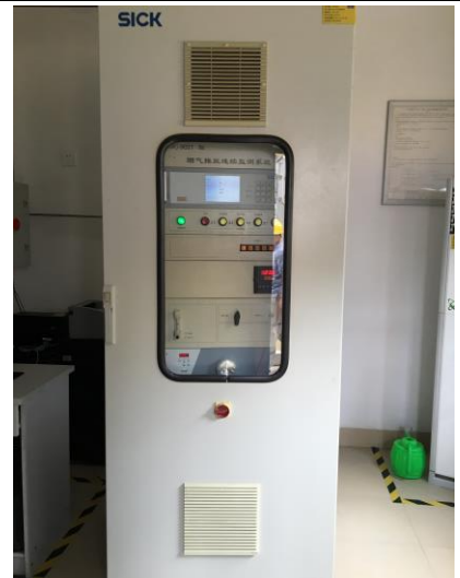
废气在线监控
