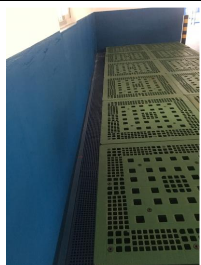
危废仓库防渗及收集沟
