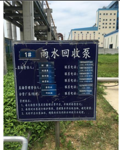
雨水排放口回收泵
