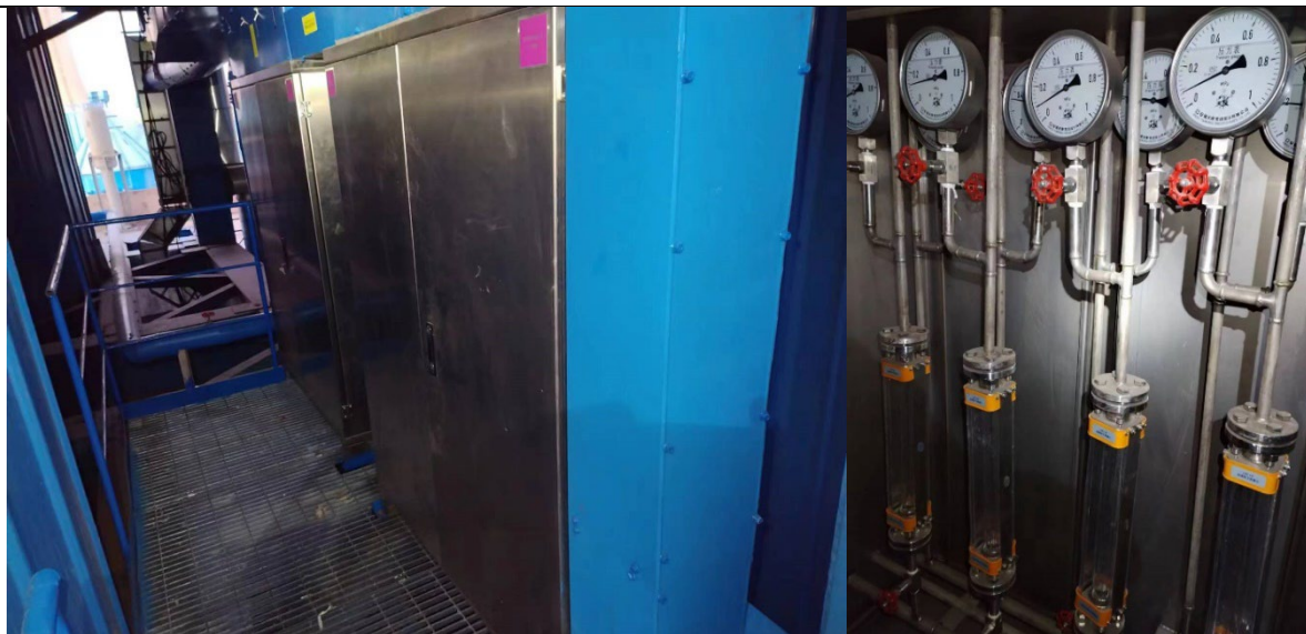
分配柜及分配柜内氨水和软水混合液压力表和压缩空气压力表
