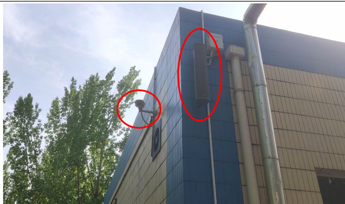
罐区出入口视频监控及广播
