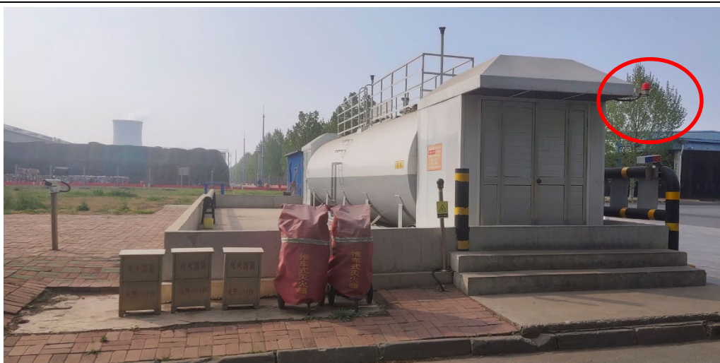
加油站围堰、报警器、消防器具、视频监控
