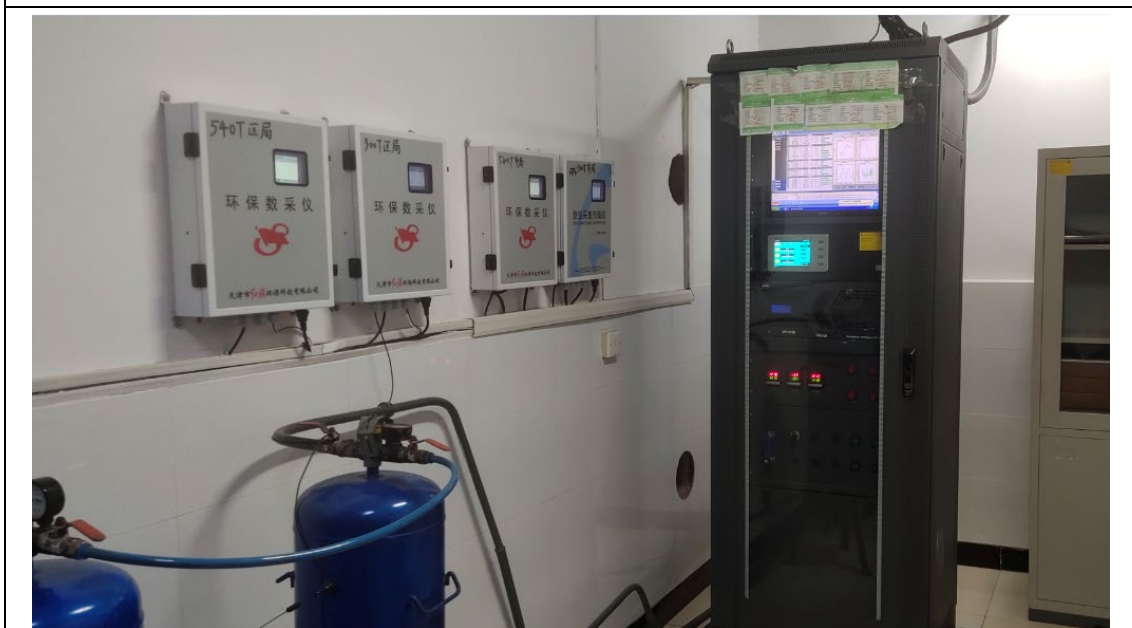
焚烧炉在线监测
