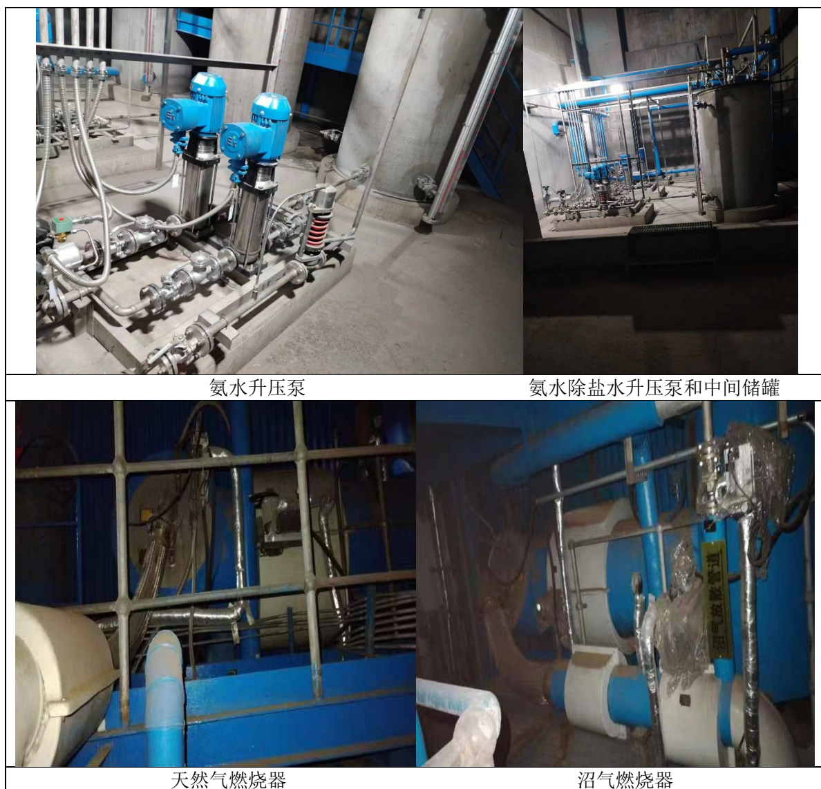
图 4-2 部分废气处理设施照片
