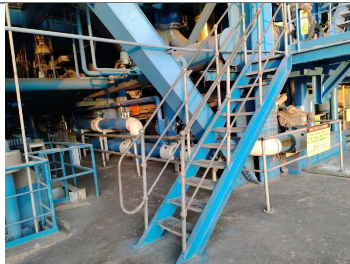
沼气系统管道
