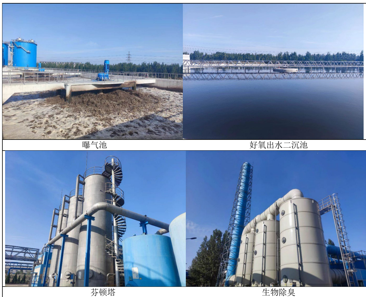
图 4-3 部分水处理设施照片
