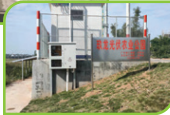
● 斜嶺村玖龍光伏農業公園
